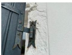
Gonds de volets en mauvais état (cf causes ci-dessus)
