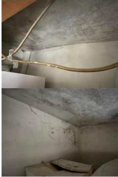
humidité plafond entrée
