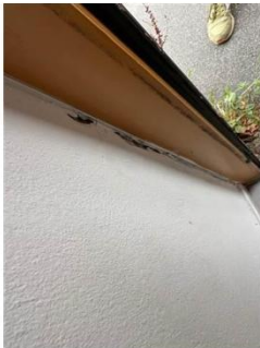
Joint de la porte d'entrée en mauvais état
