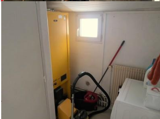
Rez de chaussée Chaufferie
